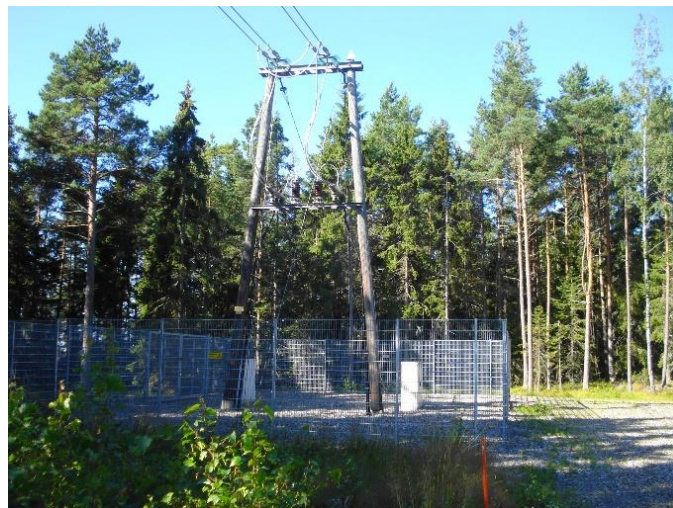
Aidattu muuntaja-alue, josta lähtee maanalainen sähkökaapeli mereen.
