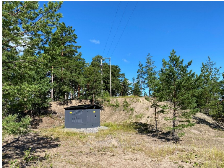
Muuntamo sekä 20 kV:n voimalinja kaava-alueen lounaisosassa.
